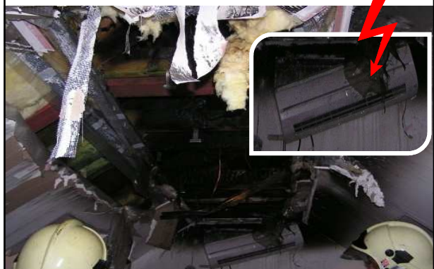
Keinen Trennungsabstand zwischen Fangeinrichtung und innere Elektroinstallation (z.B. Klimaanlage) ist beobachtet
